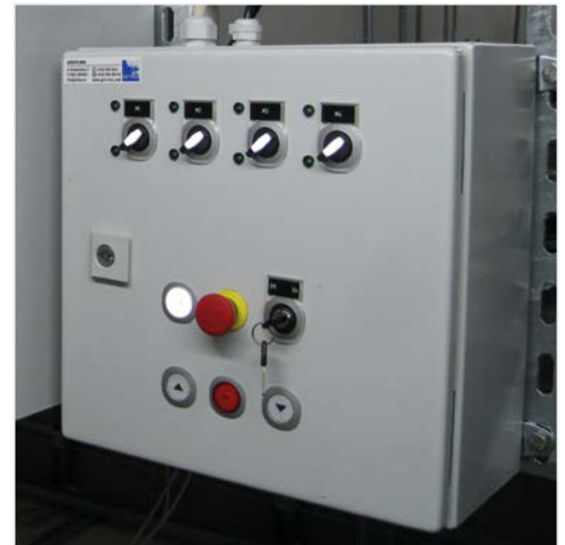
Basic Control – Bürgerhaus, Unterföhring
